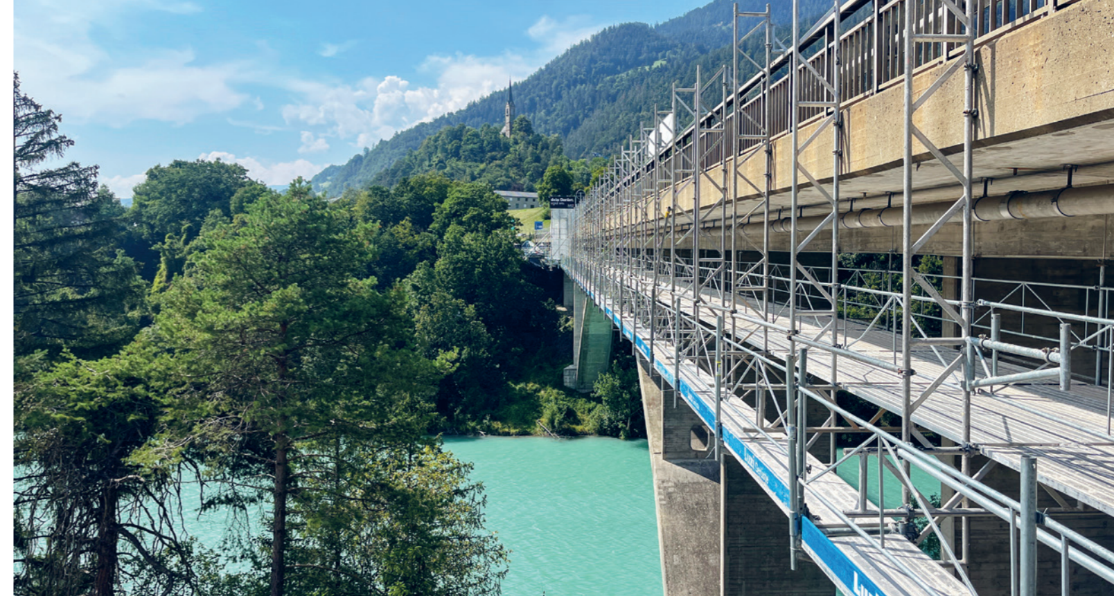
Neue Rohre an der Rheinbrücke: Über die Sommermonate wurde zeitgleich mit dem Anschluss an den Wärmeverbund auch der Anschluss an die Wasserversorgung Tamins gelegt.
