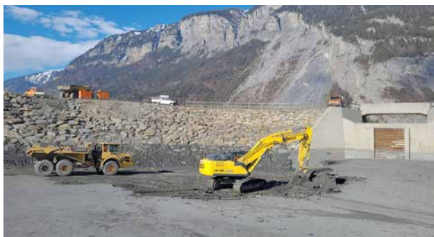
Entleerung des Geschiebefanges Val Parghera
